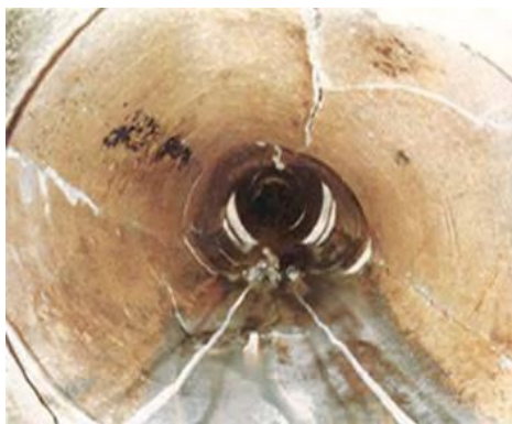
(a) 管道破损
